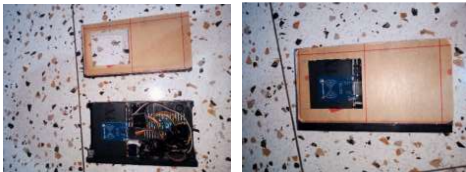
Gambar 5. Pemasangan Alat Presensi
