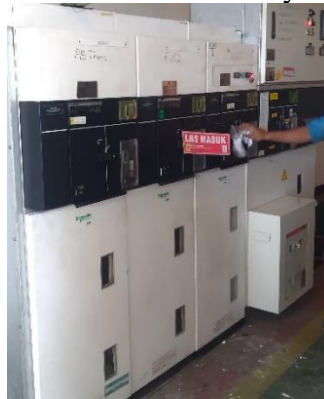
Gambar 1. Kubikel 20kV Sumber : Dokumentasi pribadi
