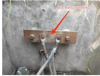
Gambar 3. 2 Bus Bar Grounding Sumber : Dokumentasi Penulis
